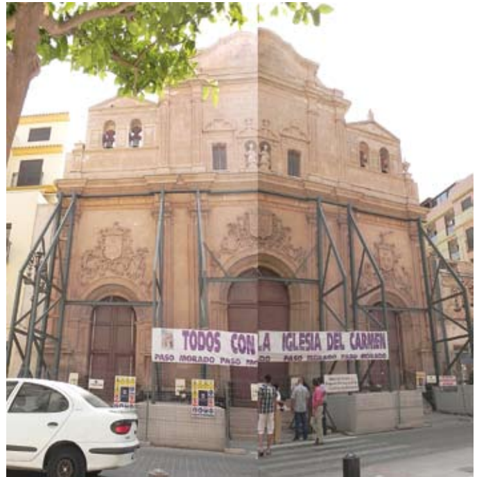
Figura 10. Fotografía de la estructura metálica colocada para detener el movimiento de “separación” de la fachada de la Iglesia de en Lorca.
