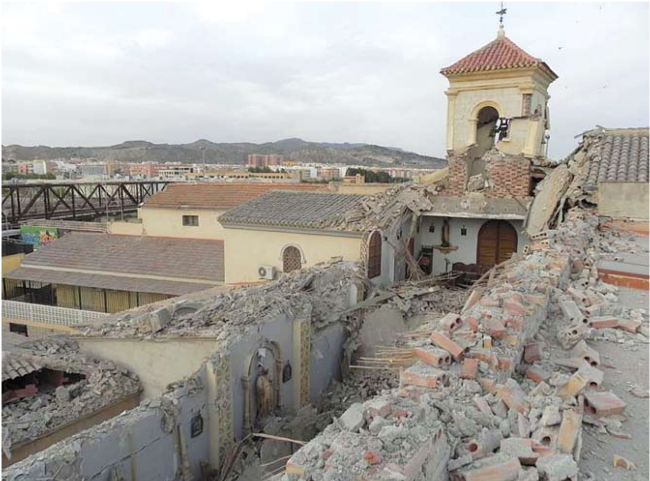
Figura 7. Estado de la Iglesia del Monasterio de Clarisas de Lorca tras el terremoto. Figure 7. The condition of the church of the Las Clarisas monastery at Lorca after the earthquake.
