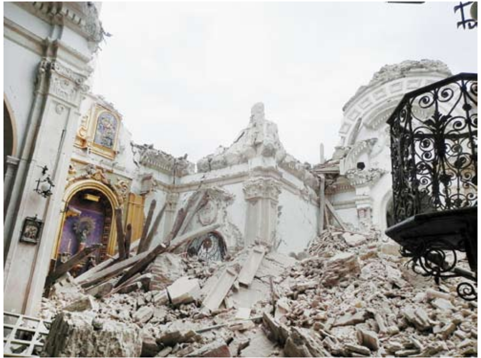
Figura 21. Escombros procedentes de la caída del tambor, cúpula y crucero de la Iglesia de Santiago en Lorca.
