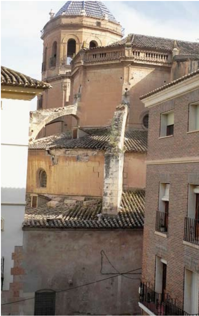
Figura 15. Caída de los sillares superiores del muro norte de la Gírola de la Ex Colegiata de San Patricio, provocado tanto por la direccionalidad de los esfuerzos del terremoto, como por el excesivo empuje que provocaban las cubiertas de hormigón pretensado y bovedilla cerámica.
