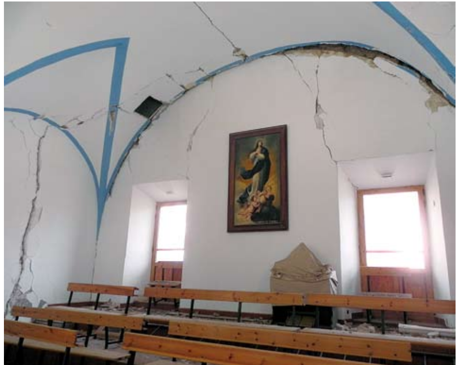
Figura 11. Apertura de una gran grieta entre la bóveda del coro y la fachada de la Iglesia de San Diego en Lorca, como consecuencia del desplazamiento de "vuelco" hacia el exterior, de dicha fachada.
