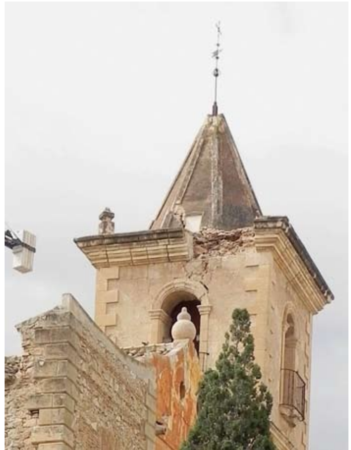
Figura 2. Sillares desprendidos de la cornisa superior de la torre de la Iglesia de san Mateo en Lorca.
