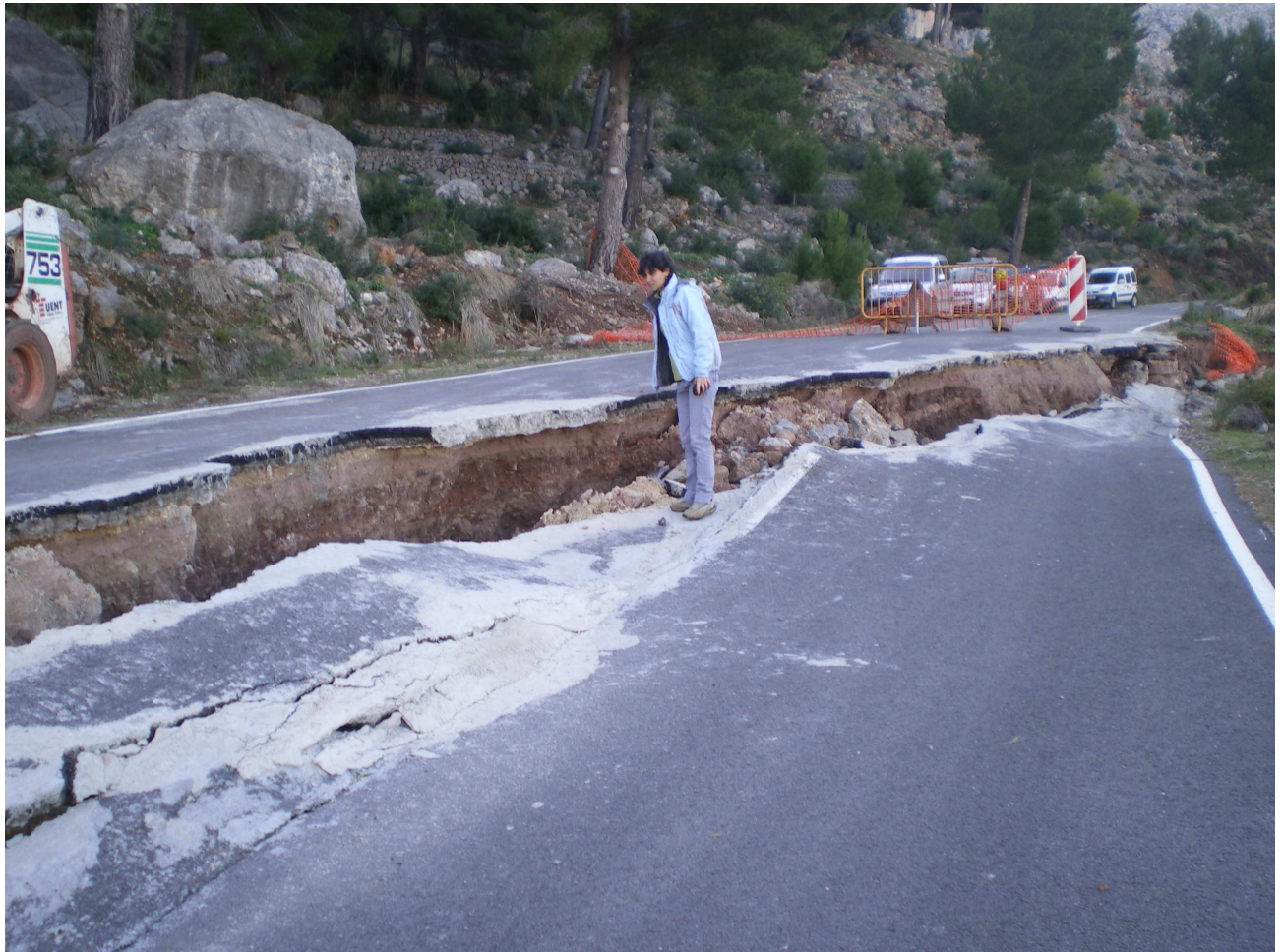
Carretera en la sierra de la Tramontana afectada por los deslizamientos producidos en diciembre de 2008.
