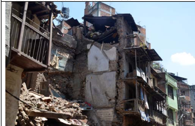
Edificio hundido junto a otro gravemente dañado en Kathmandu.
