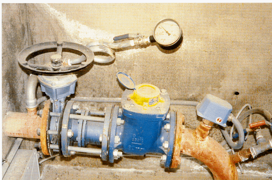
Salida de sondeo con válvula de cierre, manómetro contador volumétrico y detector de flujo para inyección de cloro.
