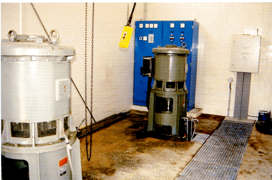
Bomba y cuadros de mando, telemida y control del sondeo del Chaparral para abastecimiento a Alcalá La Real y Frailes (Jaén).
