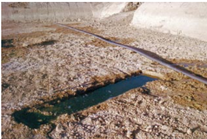
Foto 4.3 Un incorrecto manejo del suelo puede dar lugar a la aparición de zonas de flujo preferente o hundimientos que dificultan el correcto funcionamiento de las balsas.
