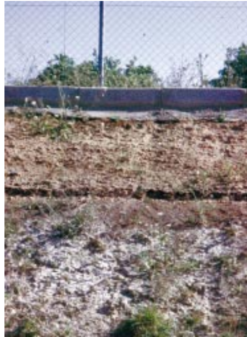
Foto 4.2 El incorrecto diseño de los taludes en los muros de separación entre balsas, puede hacer que la erosión debida a la oscilación continua del nivel del agua, arrastre el material fino al fondo de la balsa acelerando el proceso de colmatación.
