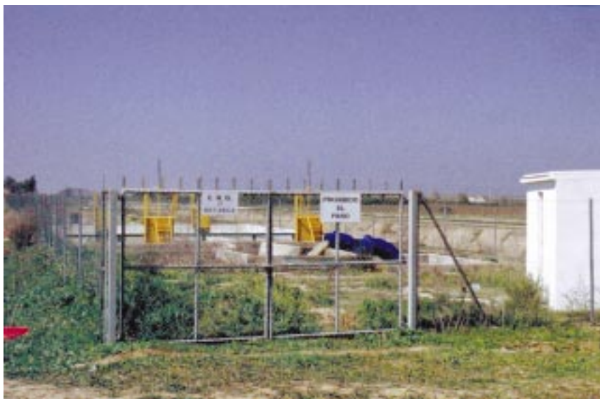
Foto 6.2 El vallado de las instalaciones constituye una medida de seguridad imprescindible, tanto para el personal de mantenimiento como para personas ajenas a las mismas.
