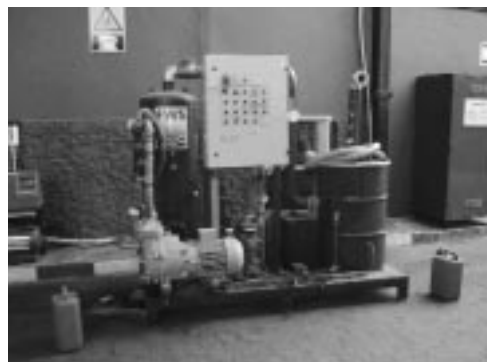
Foto 2. Equipo de Alto Vacío (“Bio-Slurping”).
