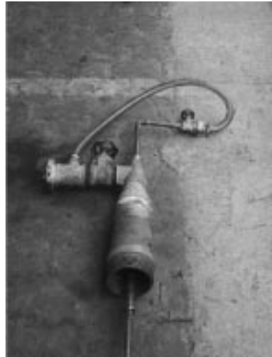
Foto 3. Detalle de la cabeza de pozo y "Slurper" para Alto Vacío.
